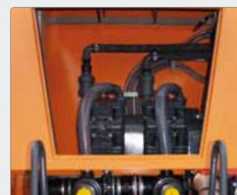
Logisk opbygget væskesystem med membranpumpe.
