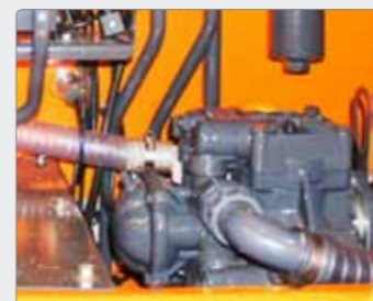
Membranpumpen for befugtning placeret i maskinrummet, hvor den er let tilgængelig for inspektion. Pumpen er kendt for nøjagtig dosering selv efter mange års brug.
